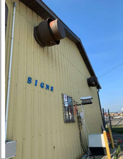
Wall exhaust fan
