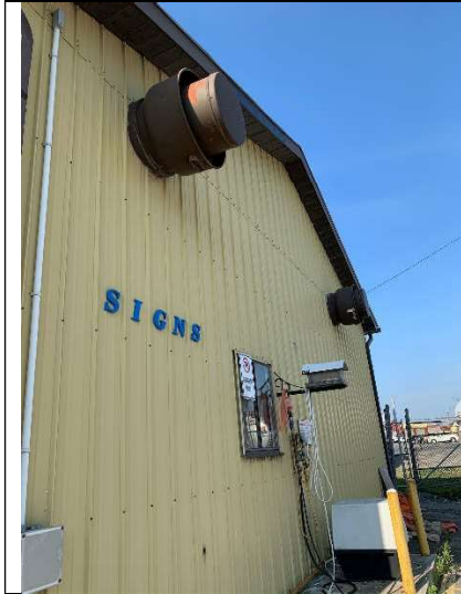
Wall exhaust fan
