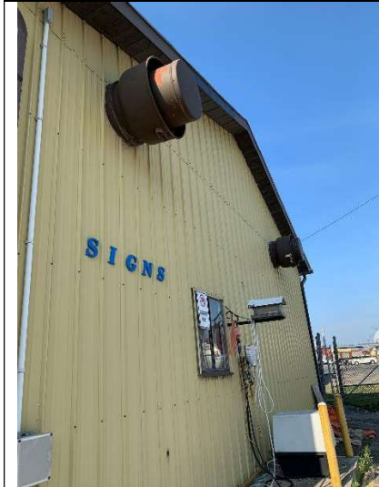
Wall exhaust fan
